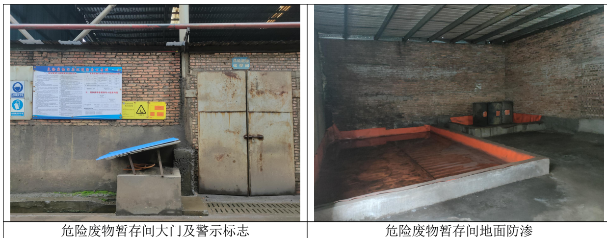
图 5.5-1 危险废物暂存间现场图
